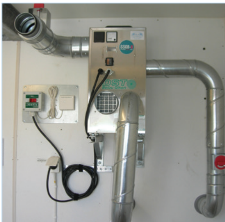
Ein DR-010B mit DST-Hygrostat EH4 regelt die Feuchtigkeit in einer Wasserpumpstation
